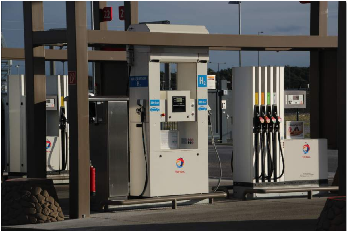
Abbildung C4.03 Zapfanlage einer Wasserstofftankstelle
