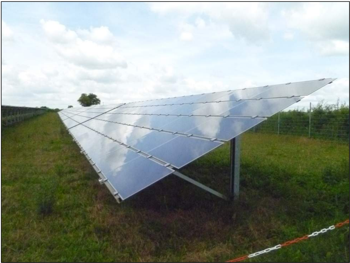
Abbildung C3.06 Solarmodulanlage in Rheinland-Pfalz
