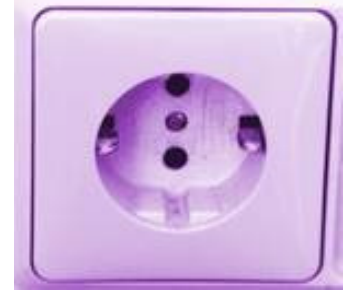
Eine Steckdose im Haus mit 230V Spannung
